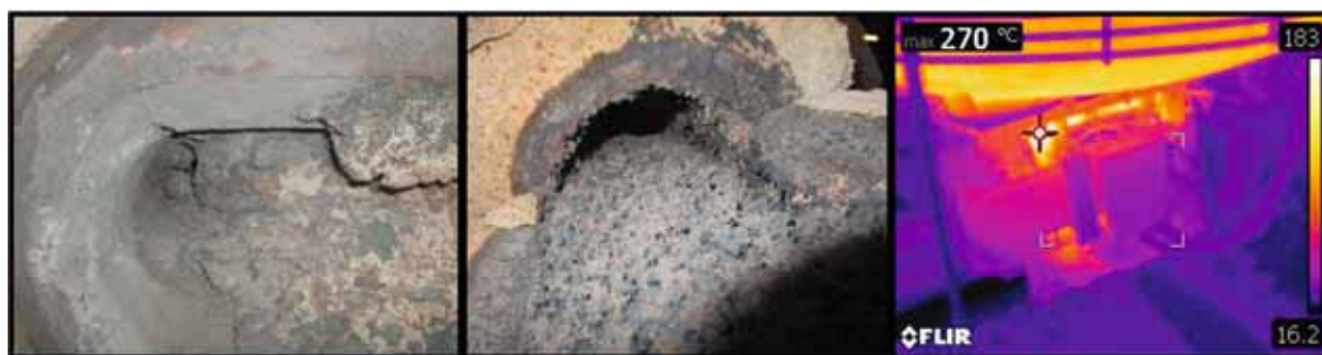
Fig. 4 - Occlusione dell'induttore e termografia.
