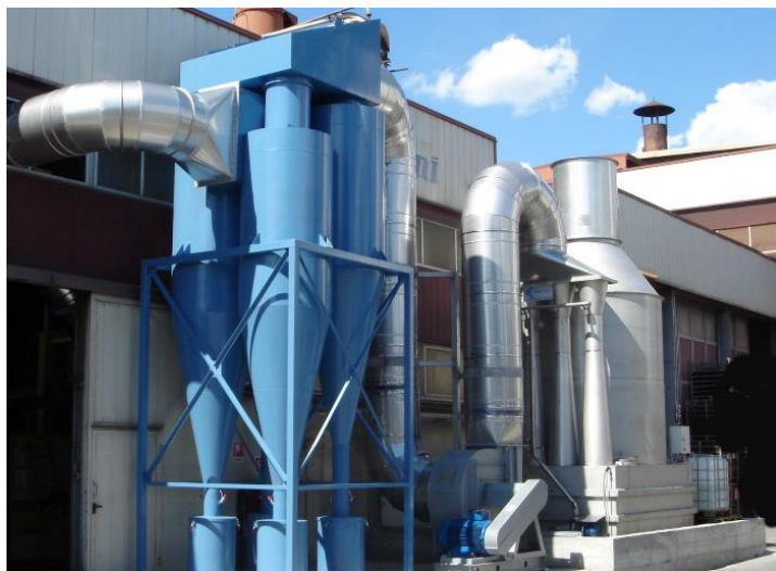
Figura 9. Venturi scrubber in ACCIAIO INOX con cicloni di preabbattimento polveri a monte.
